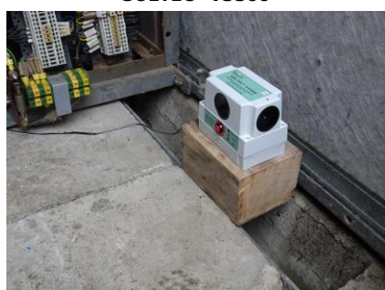
Schaltschrank bei der SNCF geschützt
